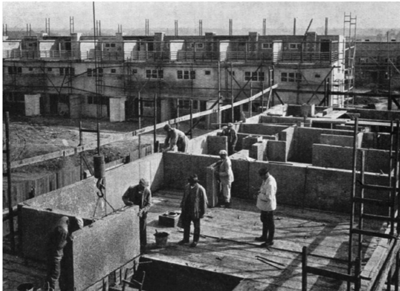
4 Baustelle mit vorgefertigten Betonteilen nach der „Plattenbauweise“ des „Neuen Frankfurt“. Reihenhäuser der Siedlung Praunheim, 1927
